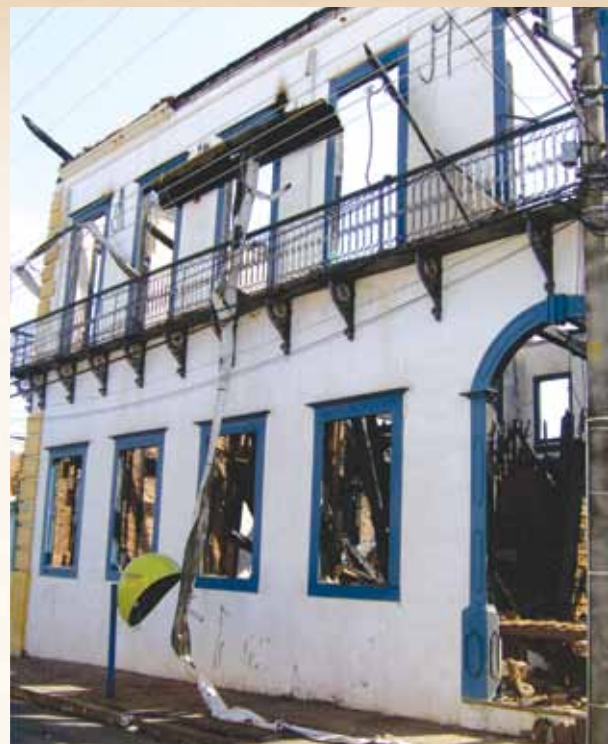
Vista da fachada principal, após o incêndio que destruiu consideravelmente a estrutura interna do edifício. Acervo da autora: Junho/2010
